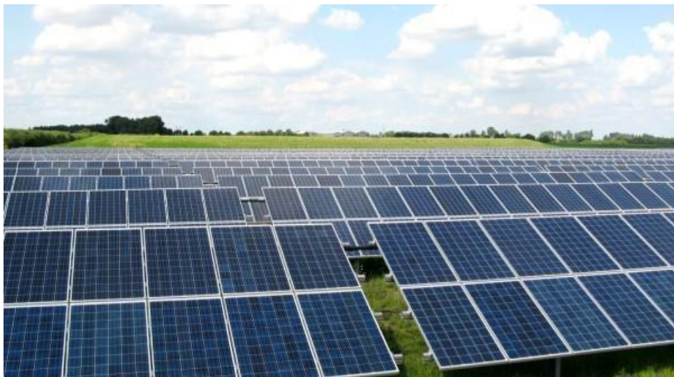
Рис.8. Внешний вид панели солнечной станции 50 МВт (100 га)
